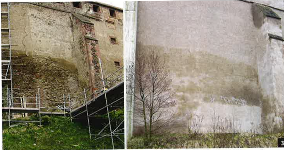
Abb. 3: Das rechte Bild zeigt einen Feuchte-regulierungsputz, links daneben ist die noch unsanierte Wand dargestellt. Die Feuchteabzeichnungen stellen keinen Mangel dar, sondern zeigen die Wirkungsweise dieser Putz-art. „Eingeweihten“ ist dies bekannt, aber in der Öffentlichkeit stößt diese Erscheinung oft auf Unverständnis und muss dem Bauherrn erklärt werden.
