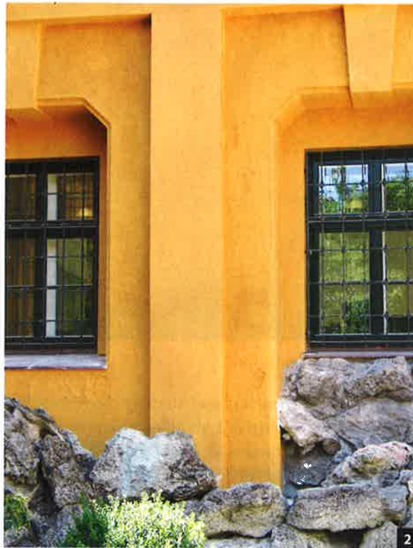
Abb. 2: Kurz nach dem Anstrich löste sich die Reinsilikatfarbe mit Teilen des Oberputzes ab. Für die hohe Spannung, die diese Anstriche auf den Untergrund aufbringen, ist der darunter befindliche Sanierputz nicht ausgelegt. Dies zeigt, wie wichtig bereits im Vorfeld gewerkeübergreifende Gespräche sind, um die spezifischen Anforderungen des Gesamtaufbaus zu kennen.
