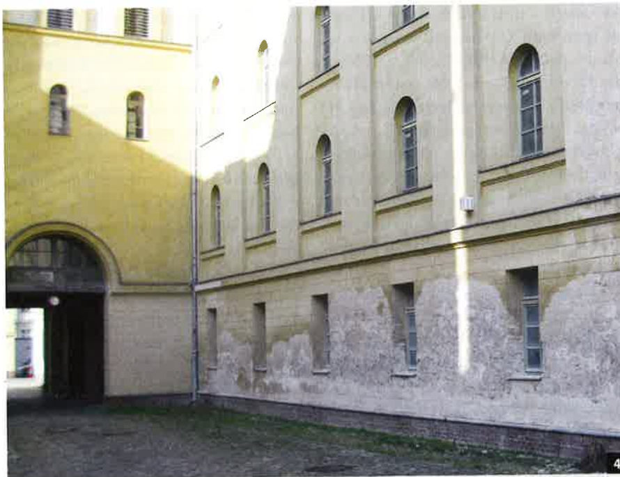
Abb. 4: Bereits wenige Monate nach der Sanierung zeigte der aufgetragene Kalkputz Salz- und Feuchteschäden. Das Bild zeigt den Zustand nach mehr als 16 Jahren. Die Verschleißschicht „Putz“ ist immer noch vorhanden, sodass das darunterliegende Mauerwerk vor der Zerstörung durch auskristallisierende Salze geschützt wird.
