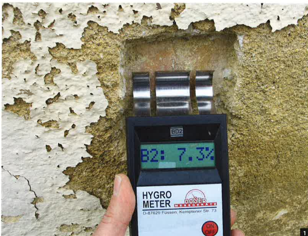
Abb. 1: Mit elektronischen Messgeräten kann man sich einfach und schnell einen Überblick über die Feuchtigkeit im Mauerwerk verschaffen. Eine Fülle von Messwerten allein ist aber nicht unbedingt ein Indiz für eine genaue Kenntnis des Untergrunds. Der Umgang, wie mit den Geräten zu messen ist, und welche Einflussfaktoren die Messung stören können, muss bekannt sein.
