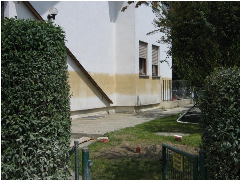
Der Hochwasserpegel ist deutlich sichtbar.
